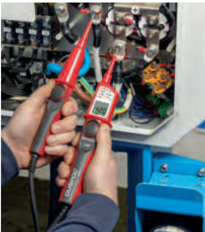
testen van de uitgangsspanning van een gelijkstroomoplader
