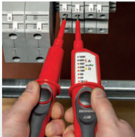
Drehfeldprüfung an den Ausgangsklemmen einer USV
