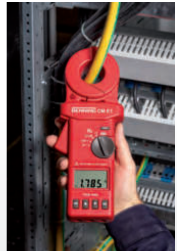
Messung des Betriebsstroms einer Industrieverteilung
