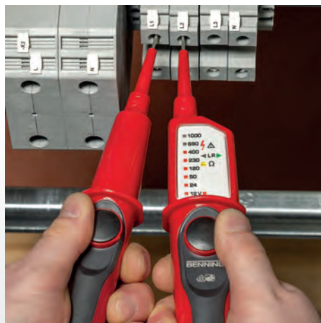
Test d'ordre de phases aux bornes de sortie d'un UPS
