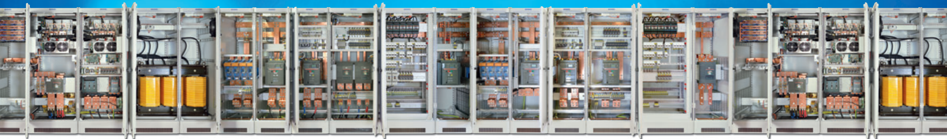
Система живлення 125 В/ DC для електростанції, що складається з випрямляча 1750 А та інверторної системи 60 кВА, модульних перетворювачів DC/DC TEBECHOP та розподільчих кабелів
