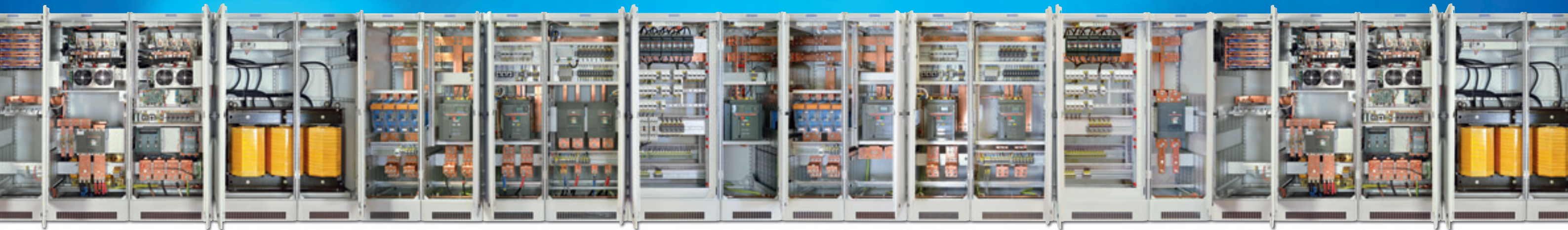
Система электроснабжения на напряжение 125 В постоянного тока для традиционной электростанции, состоящая из выпрямительных блоков на 1750 А и инверторных блоков на 60 кВт·А, а также модульных преобразователей ТЕВЕСНОР DC/DC и соответствующей кабельной разводки
